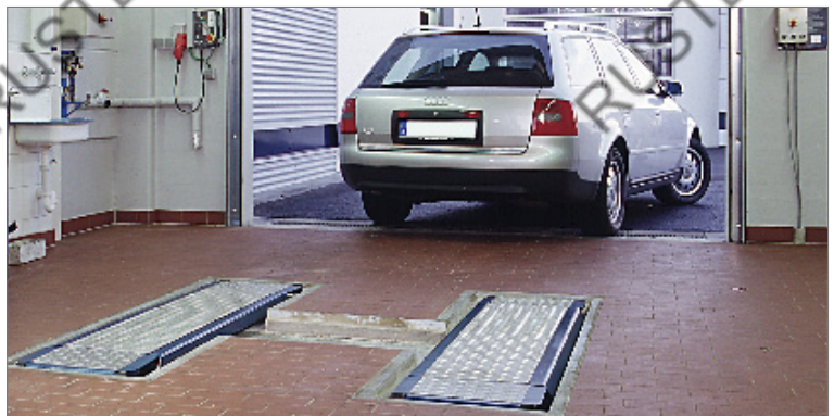
2.35 TS с платформами Universal, заглубленная установка
