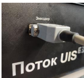
Рисунок 2.2 – Подключение кабеля энкодера
