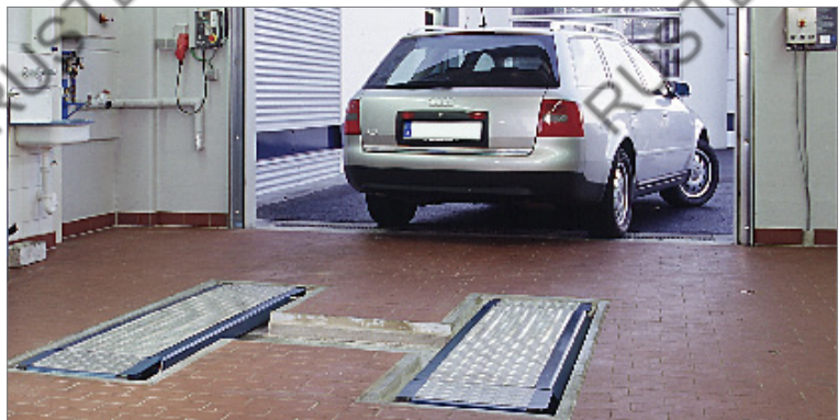
2.35 TS с платформами Universal, заглубленная установка
