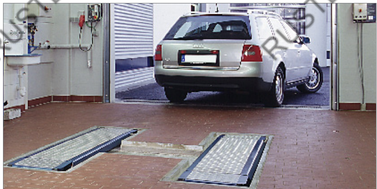
2.35 TS с платформами Universal, заглубленная установка
