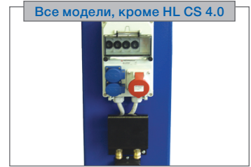
Энергоблок с подключением электричества и сжатого воздуха
